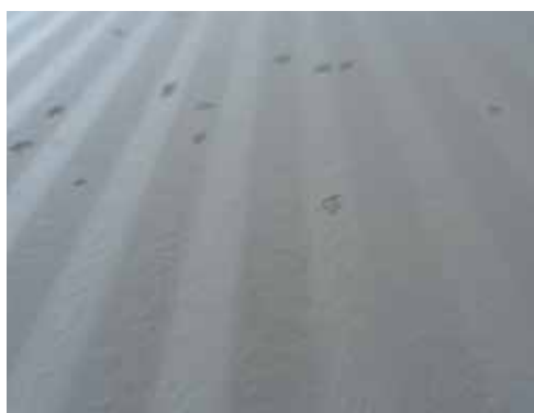
exemple de blistering
